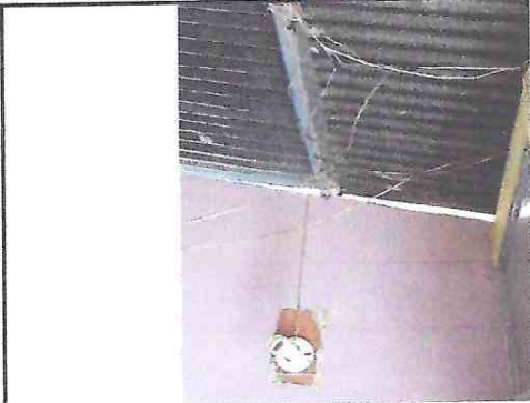
Foto 1: Cabelado electrico en malas condiciones
