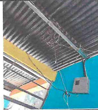
Foto 2: Cabelado electrico en malas condiciones
